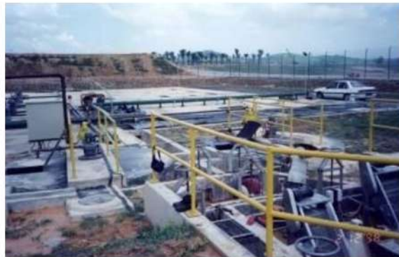
Sepang F1 sewage treatment plant
